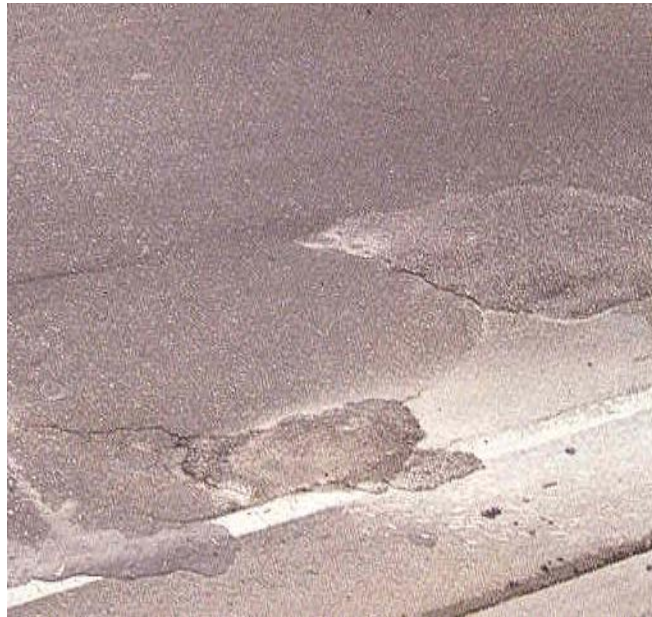
Figura I.B.7.1 Parchos y Deterioro de Parchos
