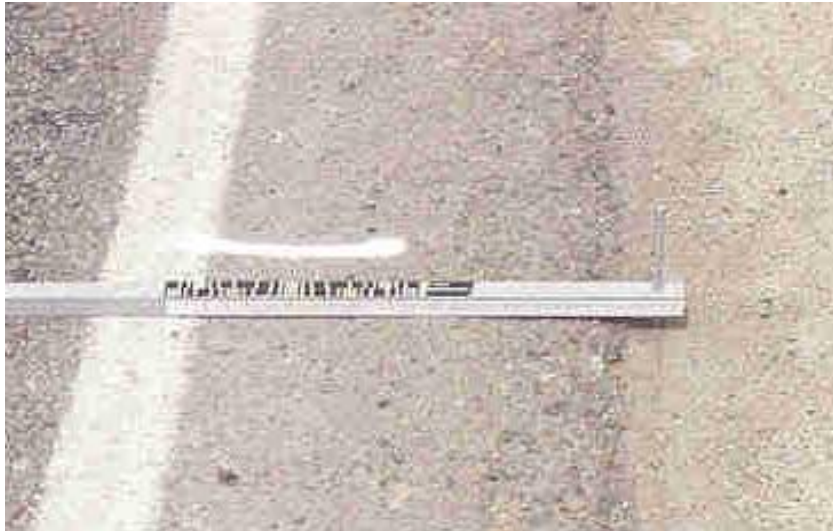
Figura I.E.14.1 Asentamiento entre el carril y el paseo
