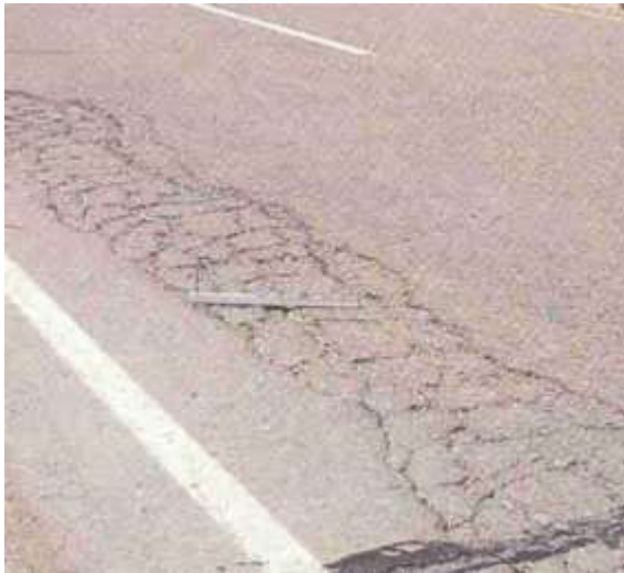
Grieta de Fatiga
