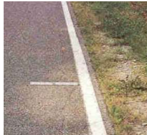
Grieta de Borde
