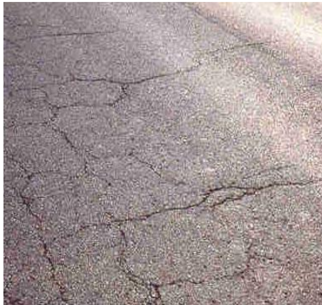
Figura I.A.2.1 Grietas de Bloque
